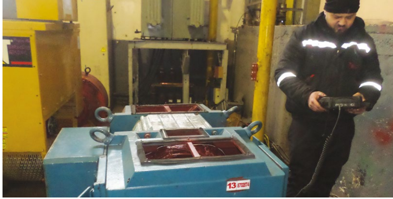
700 kW DC hadde motoru bakımı.
