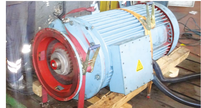
250 kW atlas copco kompresör motoru sarımı.
